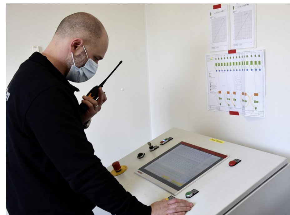
Der zentrale Leitstand befand sich in einem Baucontainer direkt auf dem Brückenkörper.
