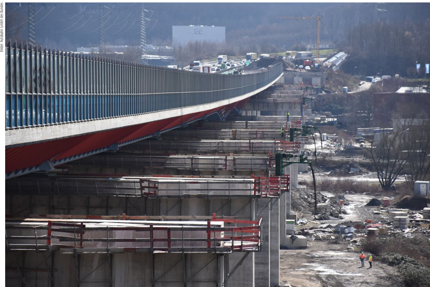
Die zu verschiebende Lennetalbrücke ist fast 1000 Meter lang. Sie ist ein zentrales Glied auf der Autobahn A45, der sogenannten Sauerlandlinie.
