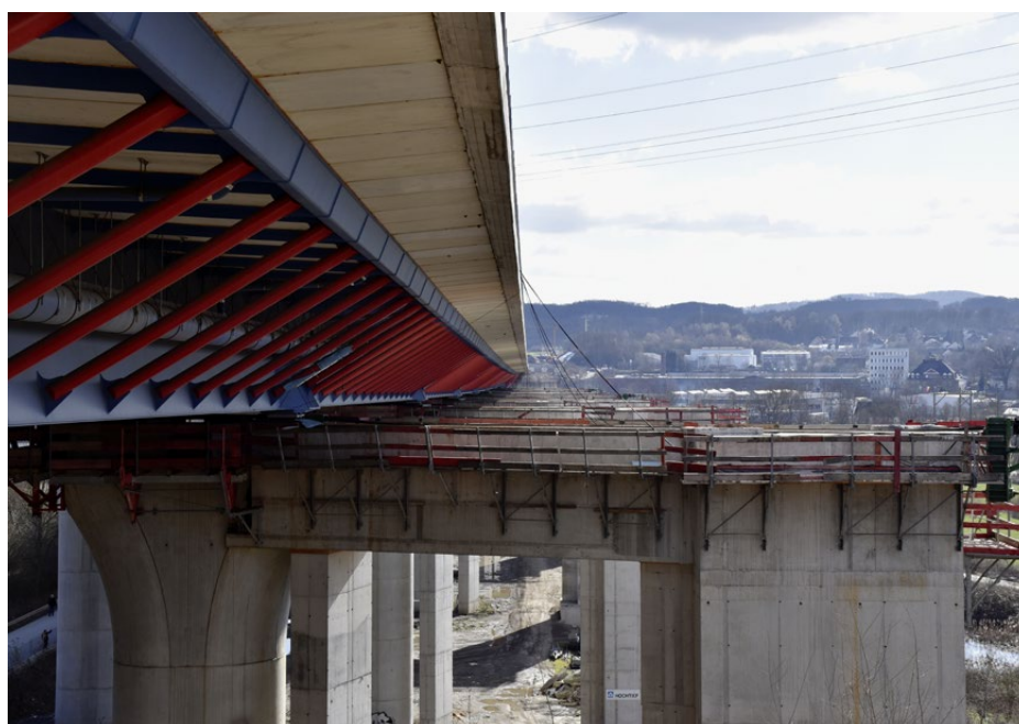
Der Überbau sitzt nun auf seinen endgültigen Pfeilern. Der Rückbau der Vershubbahnen und der Arbeitspfeiler kann nun im Anschluss erfolgen.
